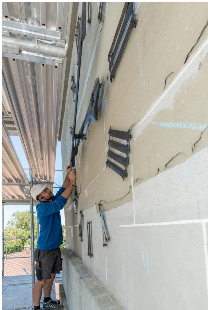
M. Burim Ramadanaj, ouvrier de l'entreprise Bugnon Echafaudages, à côté de l'horloge. On voit certains problèmes affectant les blocs de molasse.
